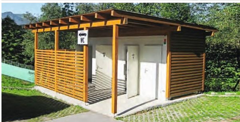
20-и футовый контейнер-туалет на стоянке
